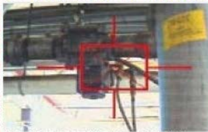
Nº2 51.5dB Gan.76 - 13/11/13 07 02 41 FOTO LOCALIZACION FUGA AIRE COMPRIMIDO www.gimateg.com
